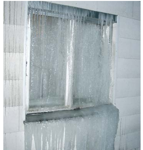
Wasserrohrbruch bei Frost
