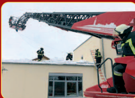
Dach von Schneelast befreit Trostberg
